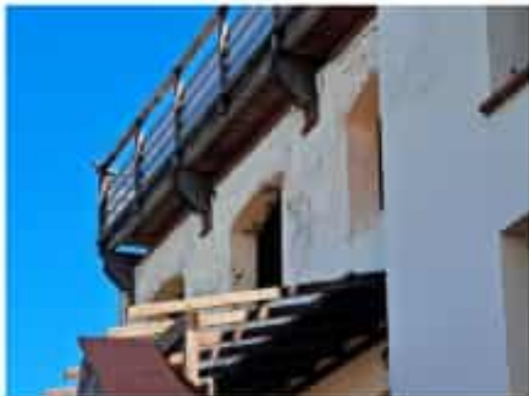
11 Fenomeni di degrado intonaco facciata lato mare
