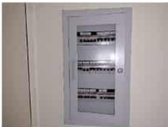
28 Vista quadro elettrico
