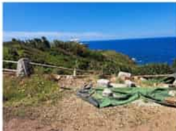
68 Dissesto lungo la recinzione della pertinenza esterna
