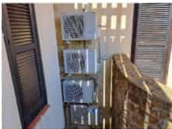
71 Unità esterne climatizzatori
