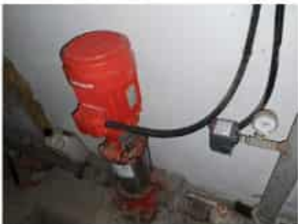
73 Pompa impianto antincendio
