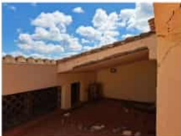
63 Terrazza, trave con degrado del copriferro
