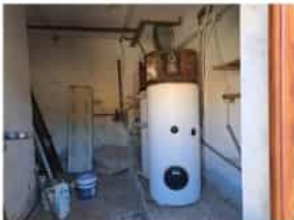
75 Vano tecnico con generatori acqua calda sanitaria
