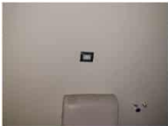
35 Presa impianto elettrico
