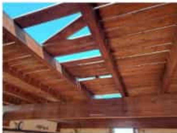
60 Instabilità del tavolato del solarium
