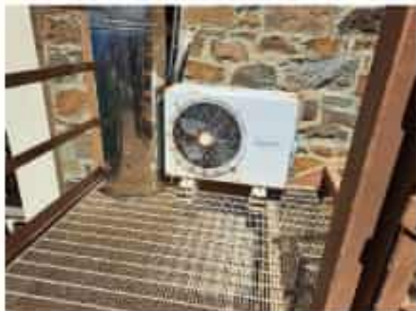
70 Unità esterna climatizzatore
