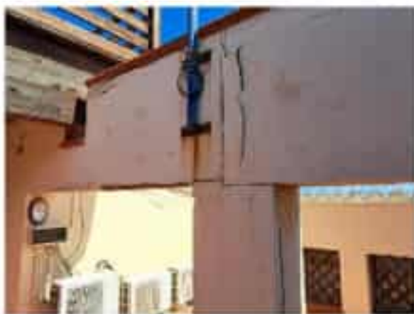
57 Terrazza Solarium, trave con degrado del copriferro
