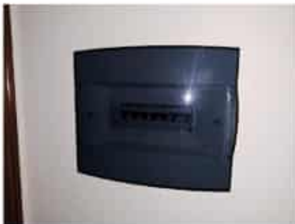
36 Quadro impianto elettrico
