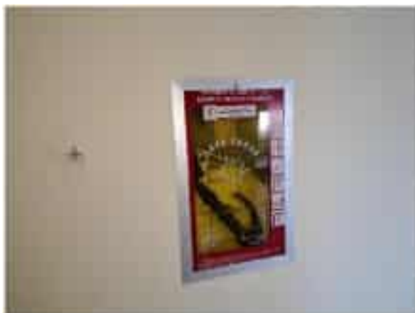
27 Nastro impianto antincendio
